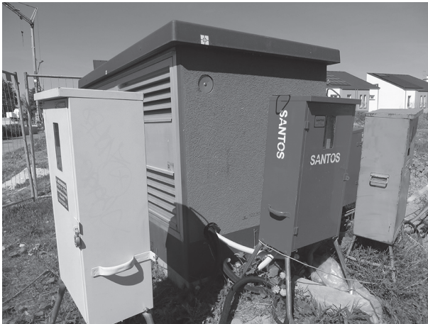
Bild 6.6 Anschluss an eine 10-kV-Station (Foto: Rolf Rüdiger Cichowski)
